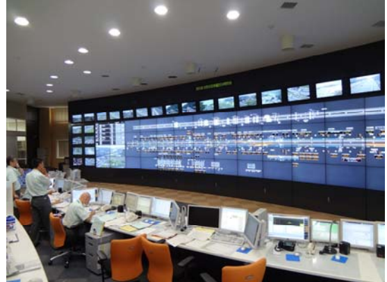
NEXCO中日本 川崎道路管制センター
