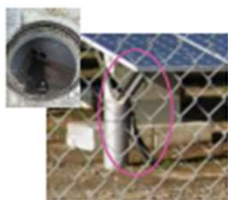
a. 地下埋設 NDTホームエレックス突出し
