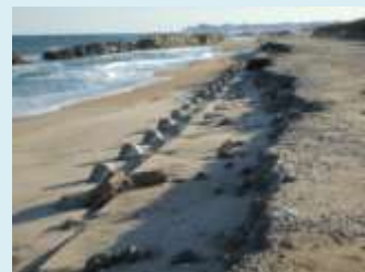
地盤沈下した海岸沿い
