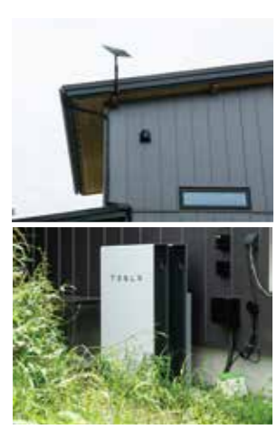
STAR LINK と Power wall
