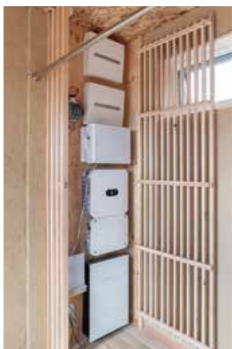
独立電源のための配電盤
