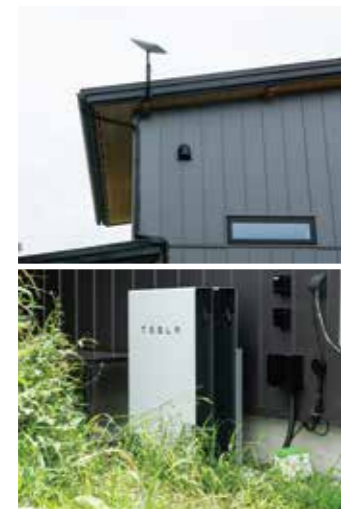
STAR LINK と Power wall
