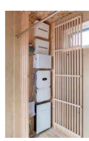
独立電源のための配電盤
