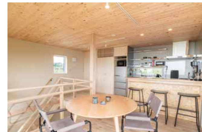
冷蔵庫左上ガラリー中に六畳用エアコン
