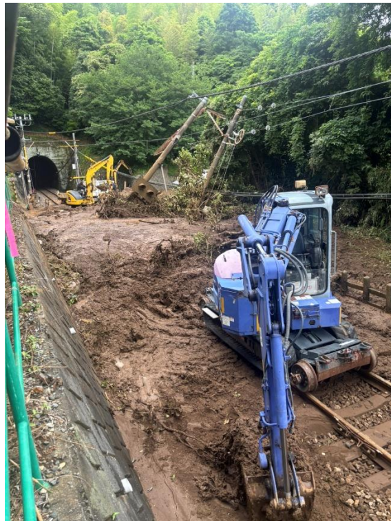
<土砂流入の現場画像③>
