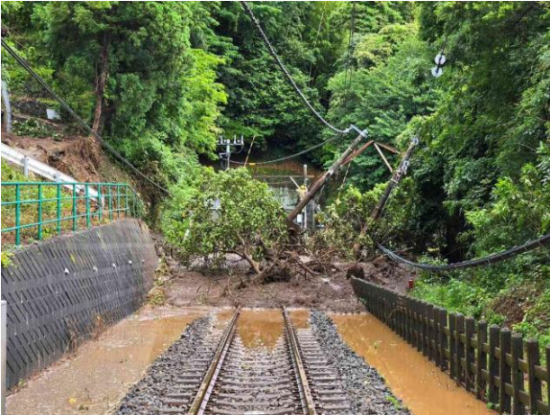
<土砂流入の現場画像①>
