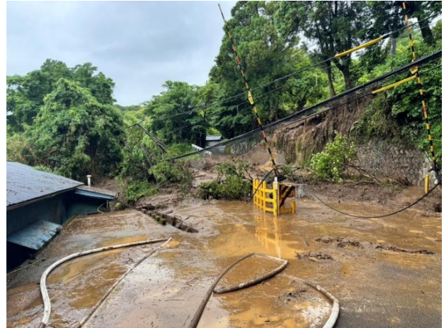
<土砂流入の現場画像②>
