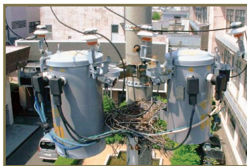
○電柱中間部の変圧器の間
